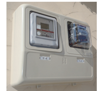
売電用電力メーターの追加
