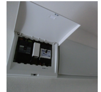
太陽光専用ブレーカー設置
