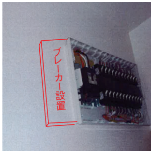
太陽光専用ブレーカー設置位置確認
